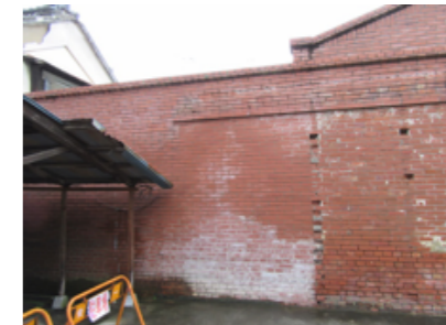
図7: 煉瓦壁に残る痕跡
