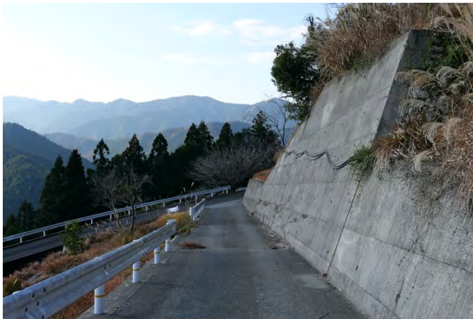
図 7 集落の反対側まで伸びる水道管（コンクリート壁の中央部）
