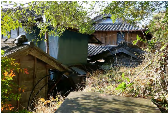
図 10 屋根の間をすり抜けていく水道管
